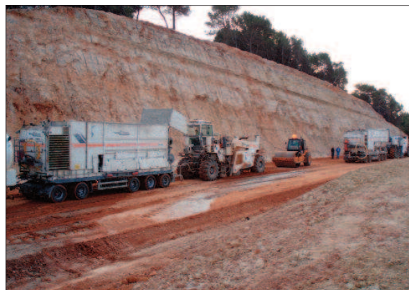
Figura 6.11 Equipos de dosificación de lechada (vía húmeda)
