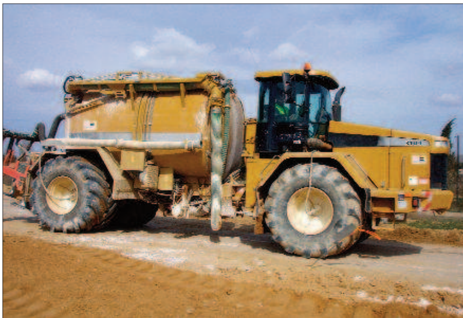
Figura 6.6 Equipo de distribución de lechada de cal
